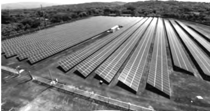
Figura 2 Planta de energía solar en Moncagua
