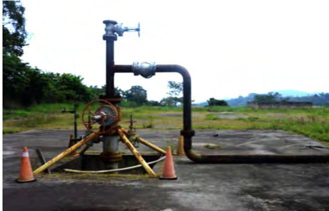
Figura 48 Bomba en pozo de reinyección geotérmica
